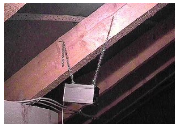
z.B.: Aufhängung im Dachboden Scheuchen in 1 Richtung
